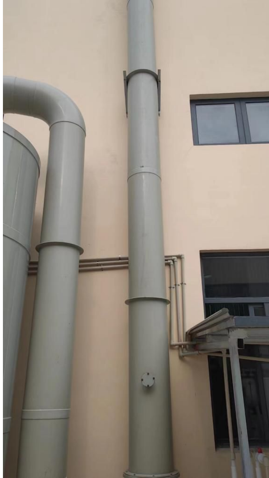
图4-3 废气处理设施照片
