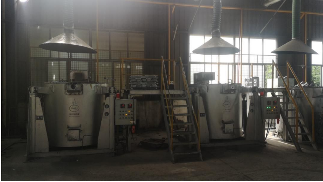
熔化废气收集设施
